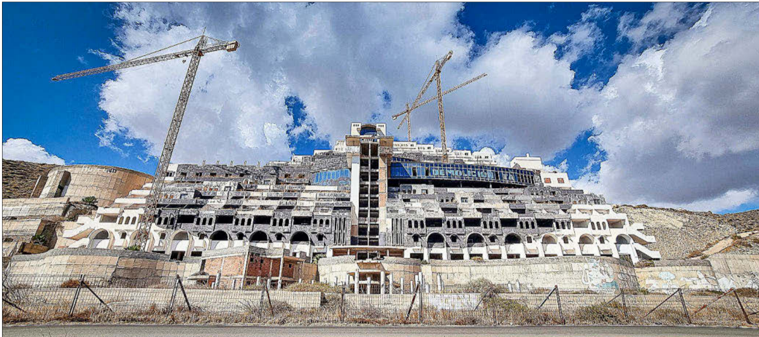
Vista general de la estructura, a medio terminar, del hotel Algarrobico, en la cala del mismo nombre de la localidad de Carboneras. J.M. CÁRDENAS
